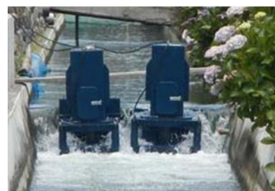
用水路に設置された小水力発電設備
