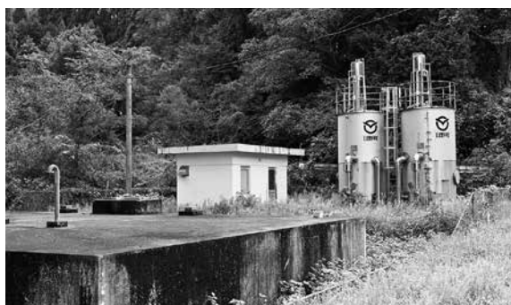
黒坂簡易水道配水施設（中菅）
