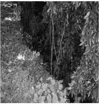
崩壊している状況の水路
