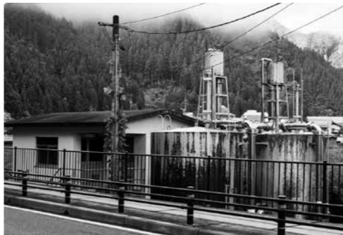
安全な水を配る簡易水道施設
