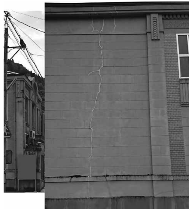
壁にクラックが生じている元山陰合同銀行根雨支店
