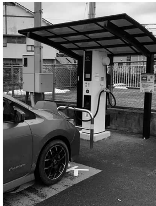
日野町にはまだない 電気自動車充電ターミナル
