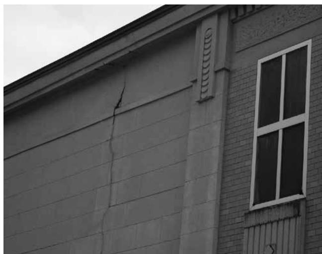
取得以来放置されてきた建物側壁のクラック
