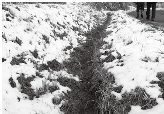
町道の側溝に土砂がつまる
