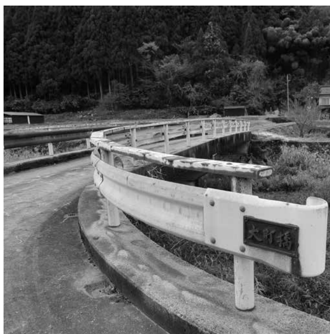
日野町道にかかる橋の劣化状態、さびているだけなのか？根巻きの状態が気にかかる。
