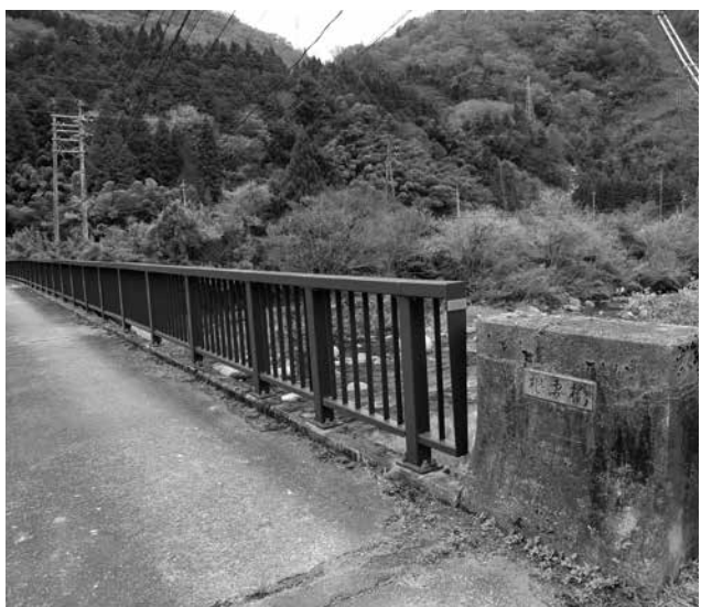
通行規制総重量4トン規制がかけられていた根妻橋。規制解除されていないのに、規制看板がない。
