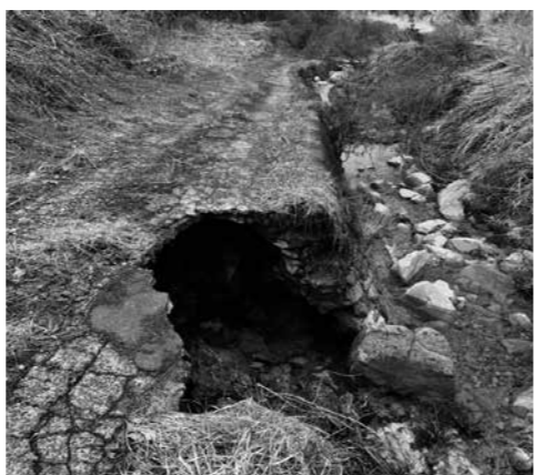
災害現場(三谷地区)
