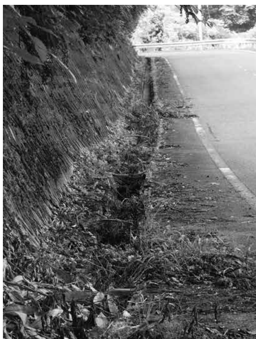
町道の側溝管理状況の現状(堆積物で埋まっている)
