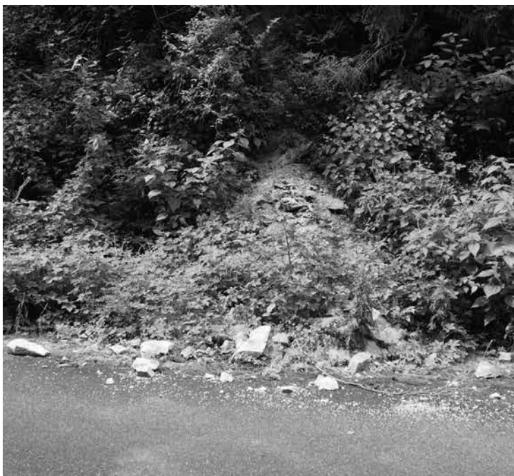
町道濁谷一滝山線、斜面の崩落現場 (石などが落ちてきて危険)
