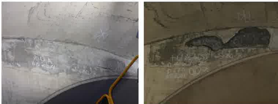
写真 5.2 S020 妻面のうき（左：除去前、右：除去後）Ⅳ→Ⅰ判定
