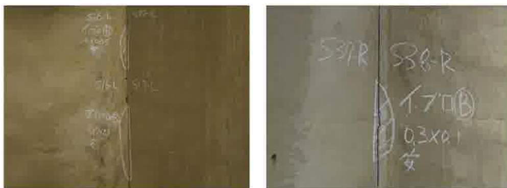
写真 5.3 目地部のブロック化 左：S016（上：Ⅱa判定、下：Ⅱb判定）、右：S038（Ⅱa判定）
