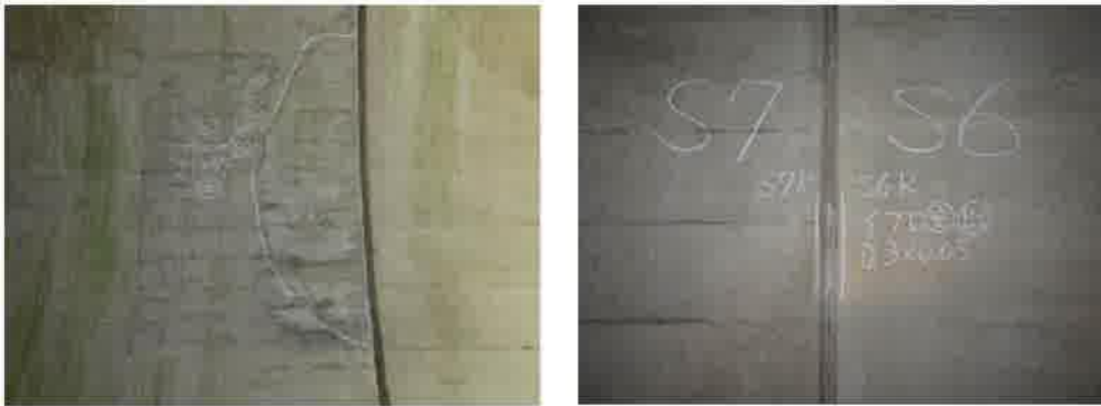
写真 5.1 目地部のブロック化 左：S002、右：S006（いずれもⅡb判定）
