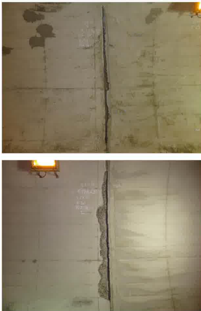
写真 5.5 モルタル部のうき 上：S008（Ⅲ→Ⅱa判定） 下：S021（Ⅳ→Ⅱa判定）
