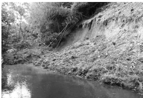
土砂崩れした日野金城線
