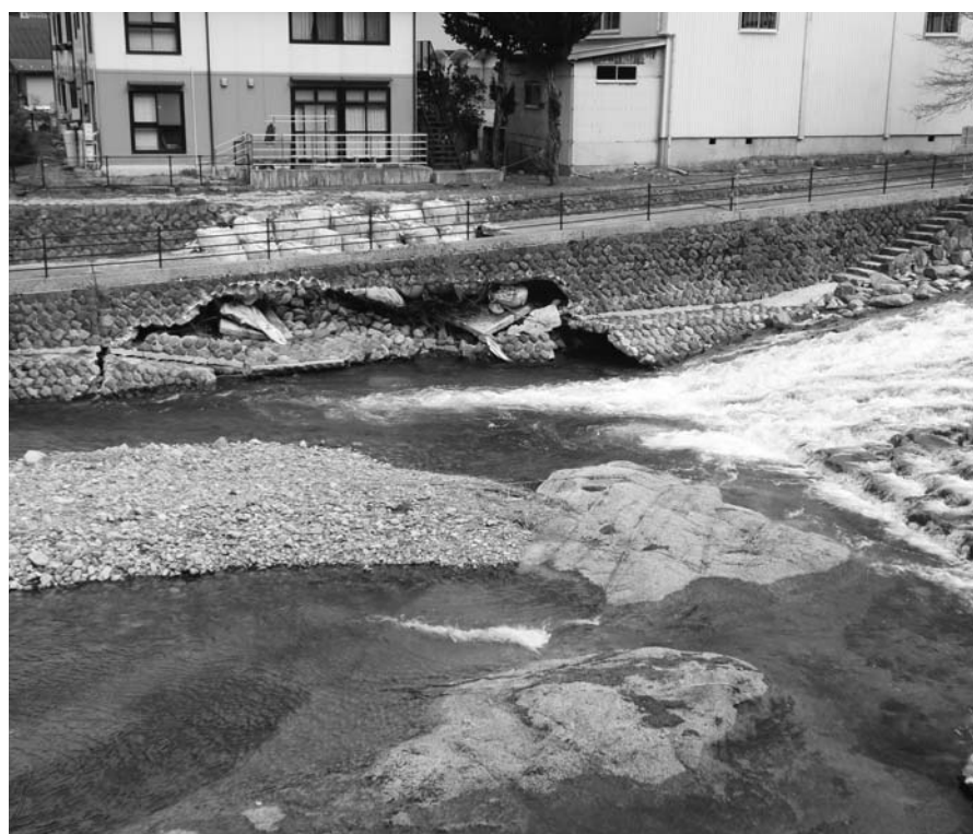
台風12号で、崩壊した板井原川堤防
