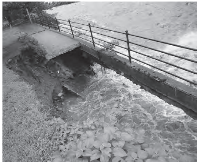
台風12号の大雨で崩れた板井原川護岸 身の危険を感じたら、速やかに避難しましょう
