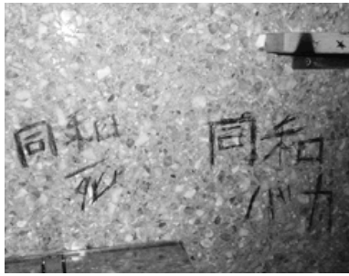
滝山公園トイレで見つかった差別落書き
