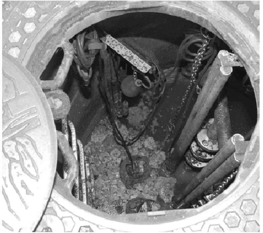
マンホールの中は、家庭から出る油成分がいっぱい
