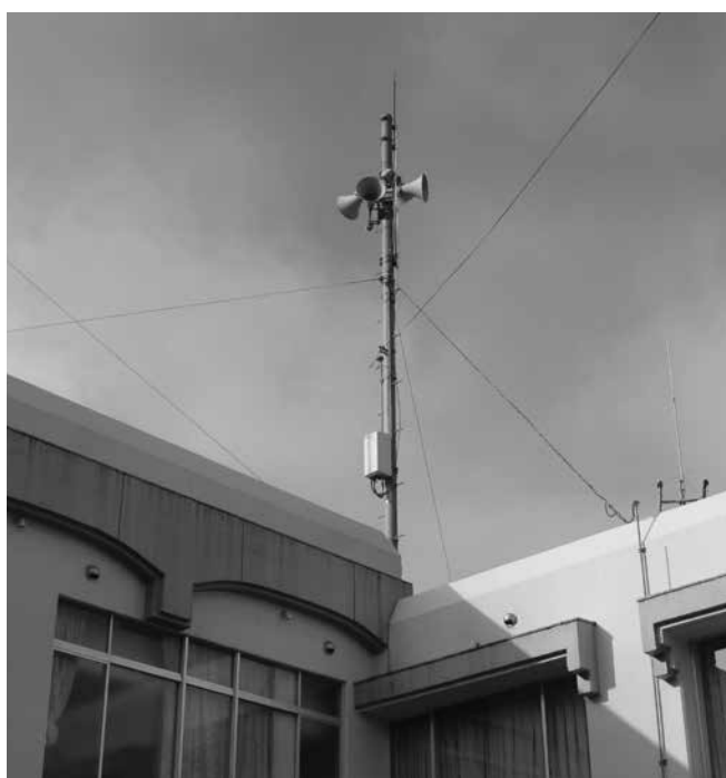
地域防災放送設備（黒坂公民館）
