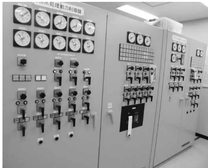
センター内の動力制御盤
