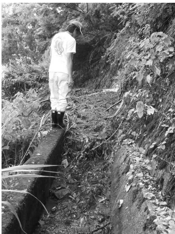
土砂に埋まった水路
