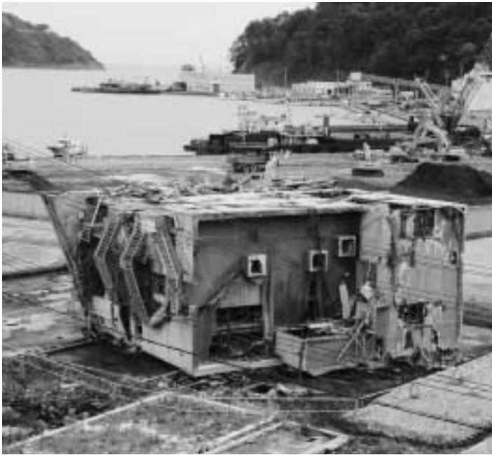
倒壊したビル（女川町）
