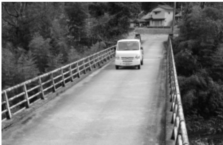
老朽化が進んでいる上菅橋
