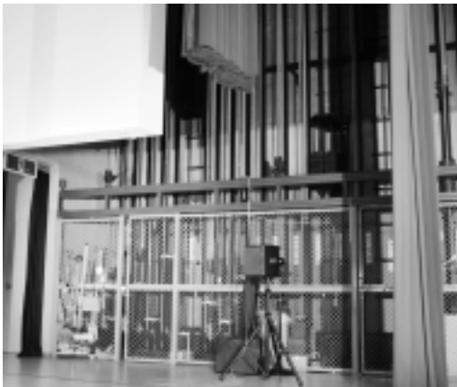
文化センター設備の老朽化が進む
