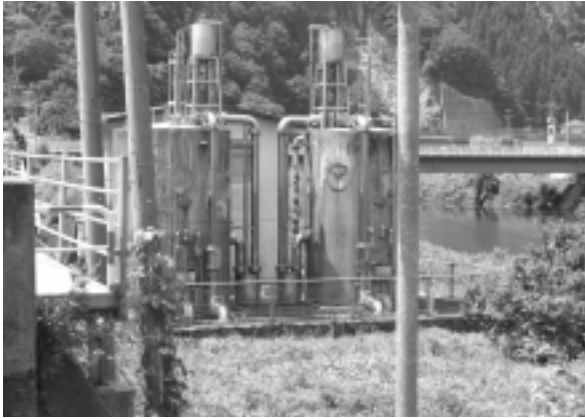
根雨地区簡易水道の水源地
