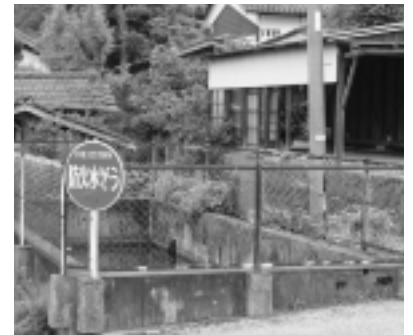
防火水槽を4ヶ所に設置
