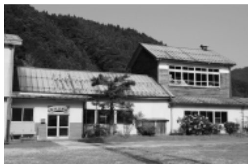
老朽化した屋根の修繕
