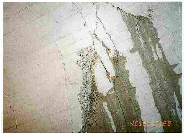
トンネル内部も亀裂が生じる（大規模林道日野金城線）
