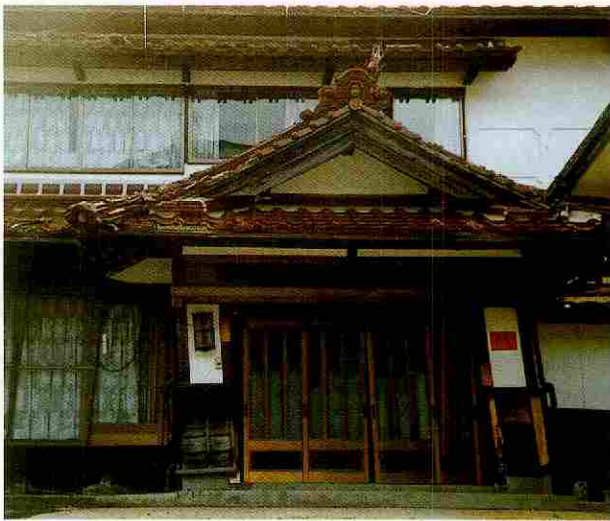
外見は良くても柱が傾いた家屋（下榎地内）
