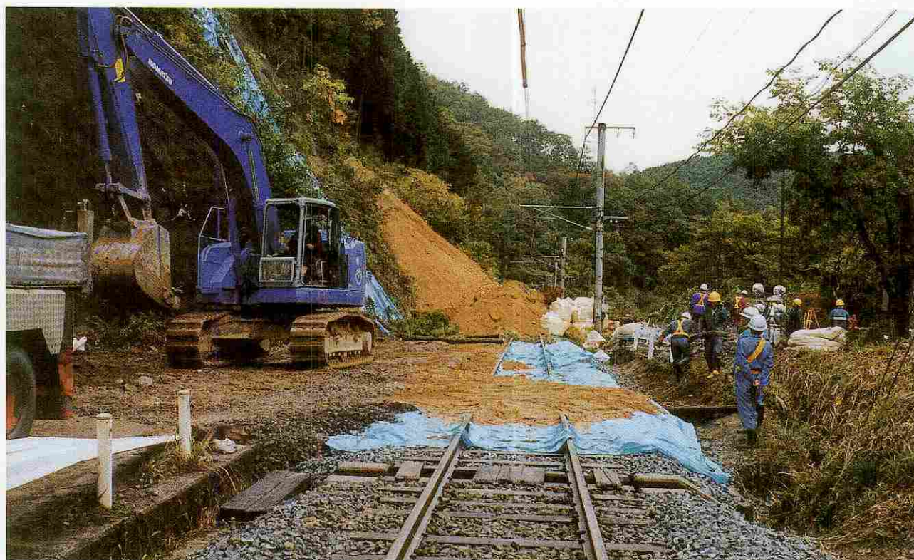
JR伯備線も山林の土砂崩れのため20日間にわたって一部不通に、その間バスで代替輸送（下黒坂地内）
