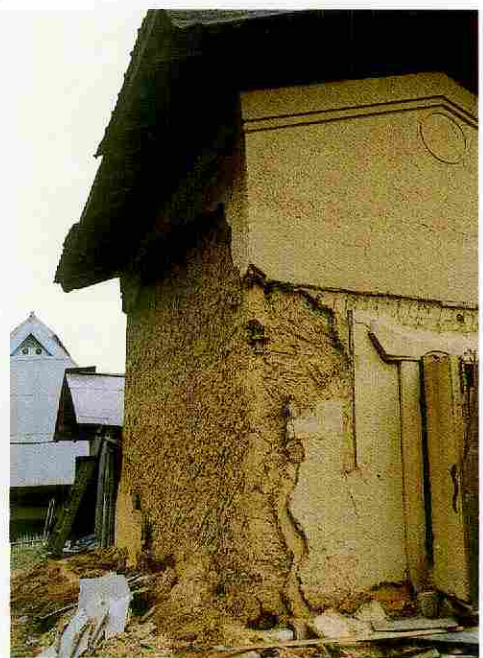
壁が落ちるなど土蔵の被害が多いのも特徴（別所地内）
