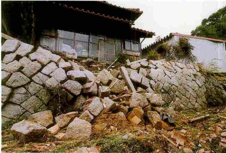
住宅の周りの石崖や擁壁が崩れる被害も発生（下黒坂地内）
