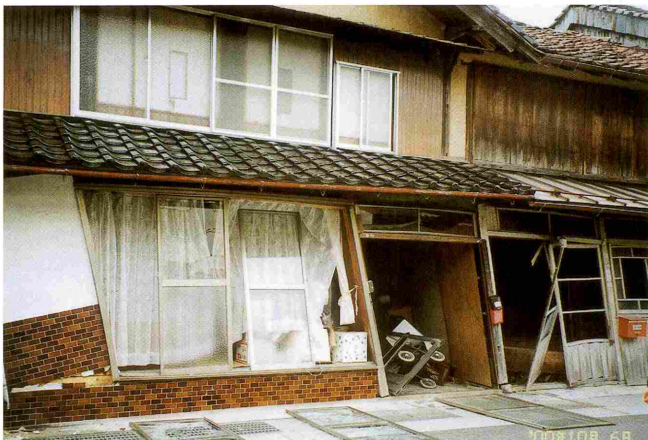
震源に近い黒坂、下黒坂、下榎などに大きな被害をもたらした(黒坂地内)
