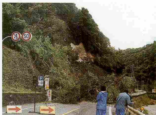
国道の数が所に土砂が流出し、道をふさいだ（国道180号・本郷地内）
